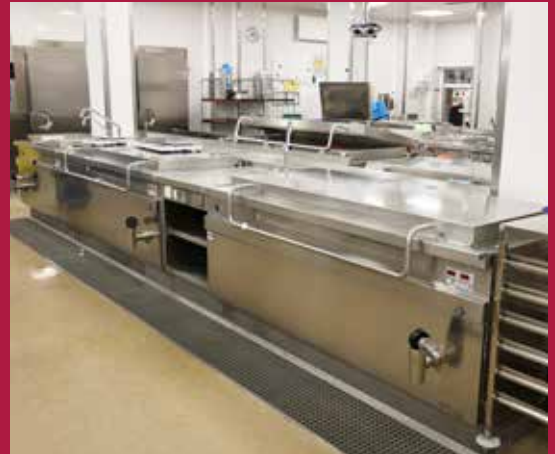
Moderne dampfbetriebene Kochkessel.
